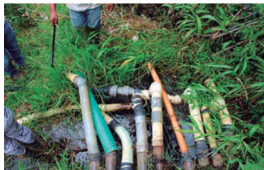
Bocatoma de los acueductos comunitarios pegada al rebose del Tanque Los Toldos
