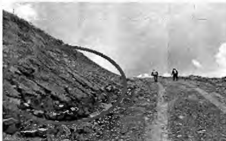
Fuente: Registro fotográfico CGR del día 17 de abril de 2018, procesos erosivos en el depósito Km 9+750.
